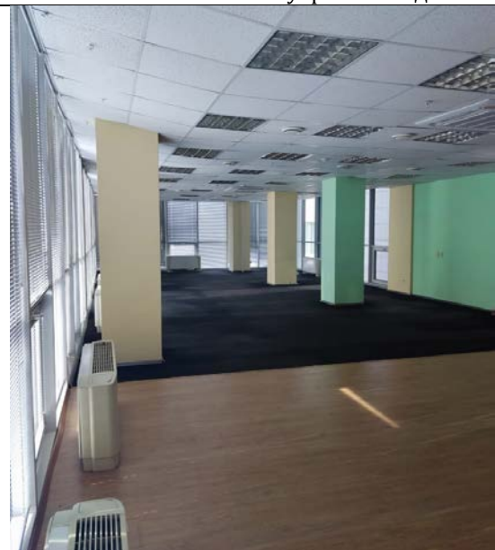
ФОТО № 20. Состояние внутренней отделки.
