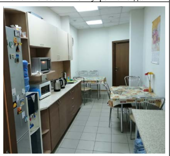
ФОТО № 10. Состояние внутренней отделки.
