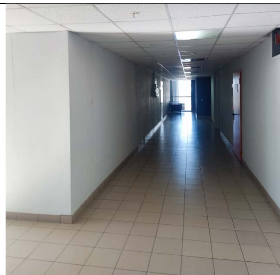
ФОТО № 18. Состояние внутренней отделки.
