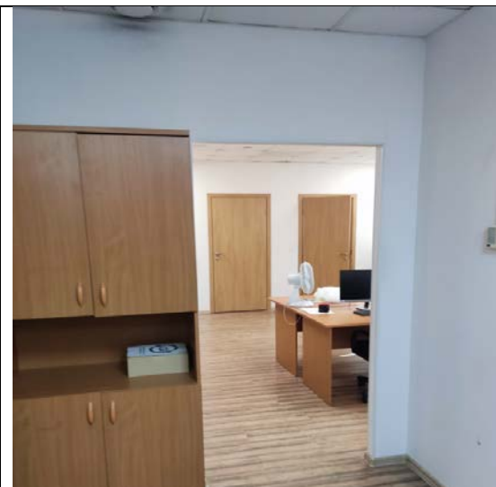
ФОТО № 17. Состояние внутренней отделки.
