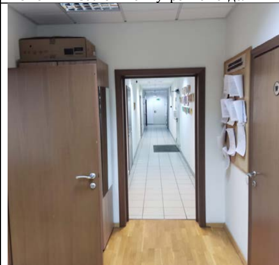
ФОТО № 9. Состояние внутренней отделки.
