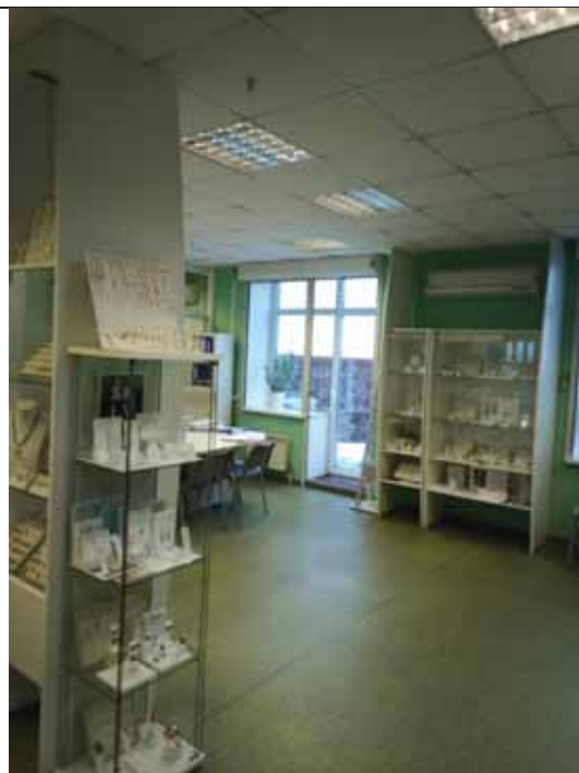
ФОТО № 2. Состояние внутренней отделки
