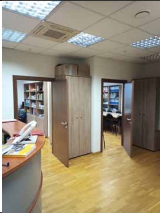
ФОТО № 6.Состояние внутренней отделки
