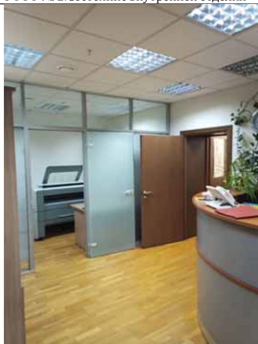
ФОТО № 4. Состояние внутренней отделки
