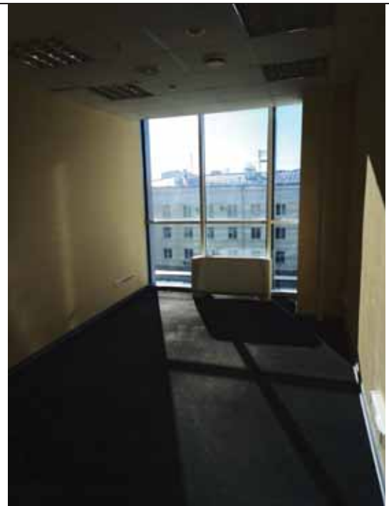
ФОТО № 10.Состояние внутренней отделки
