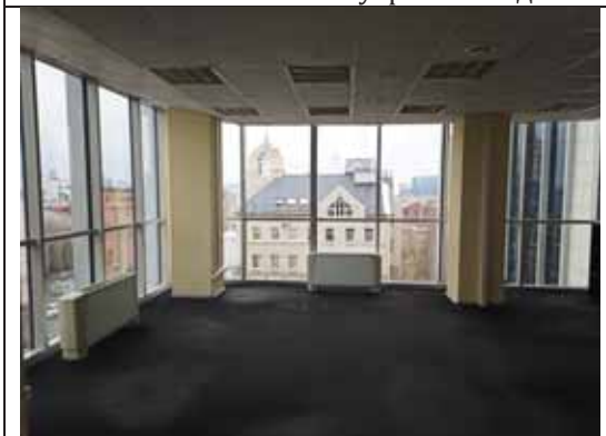
ФОТО № 13.Состояние внутренней отделки
