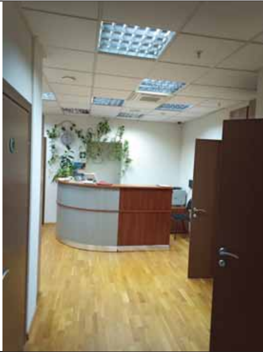
ФОТО № 5.Состояние внутренней отделки
